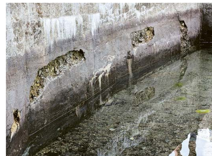
VIDNE POŠKODBE NA JEZU
