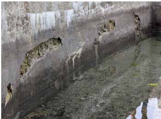
VIDNE POŠKODBE NA JEZU
