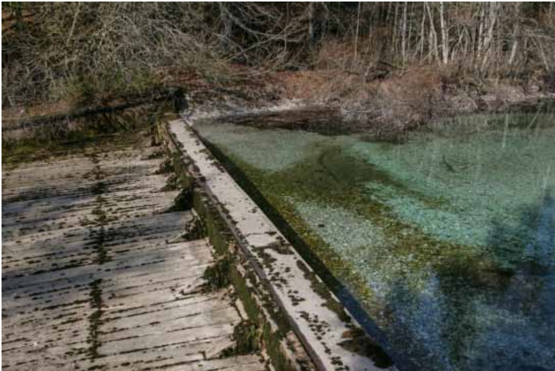
Slika 1: Desna brežina reke Radovne ob jezu dne 22.3.2012 (arhiv JZ TNP)
